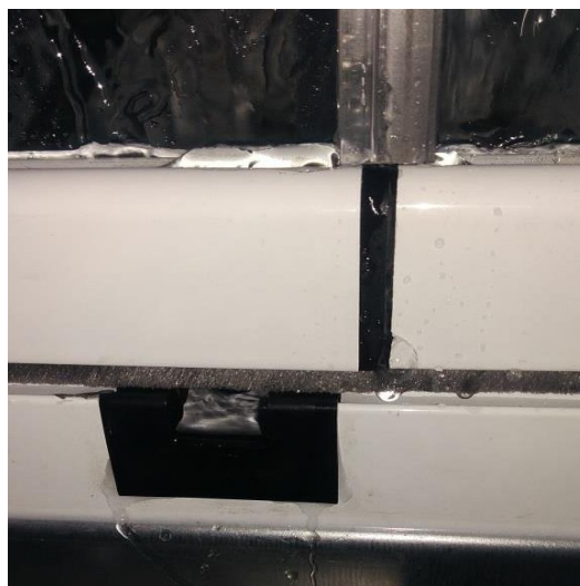
Detalle zona de filtración de agua
